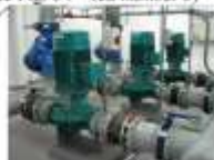
Fig. 33: Pumps 3x55 kW
